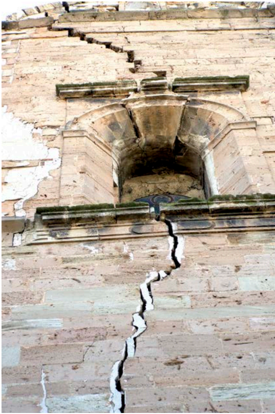
Fig. 6.- Grieta en la fachada principal. 1981. Fotografía: J. Alabau.
