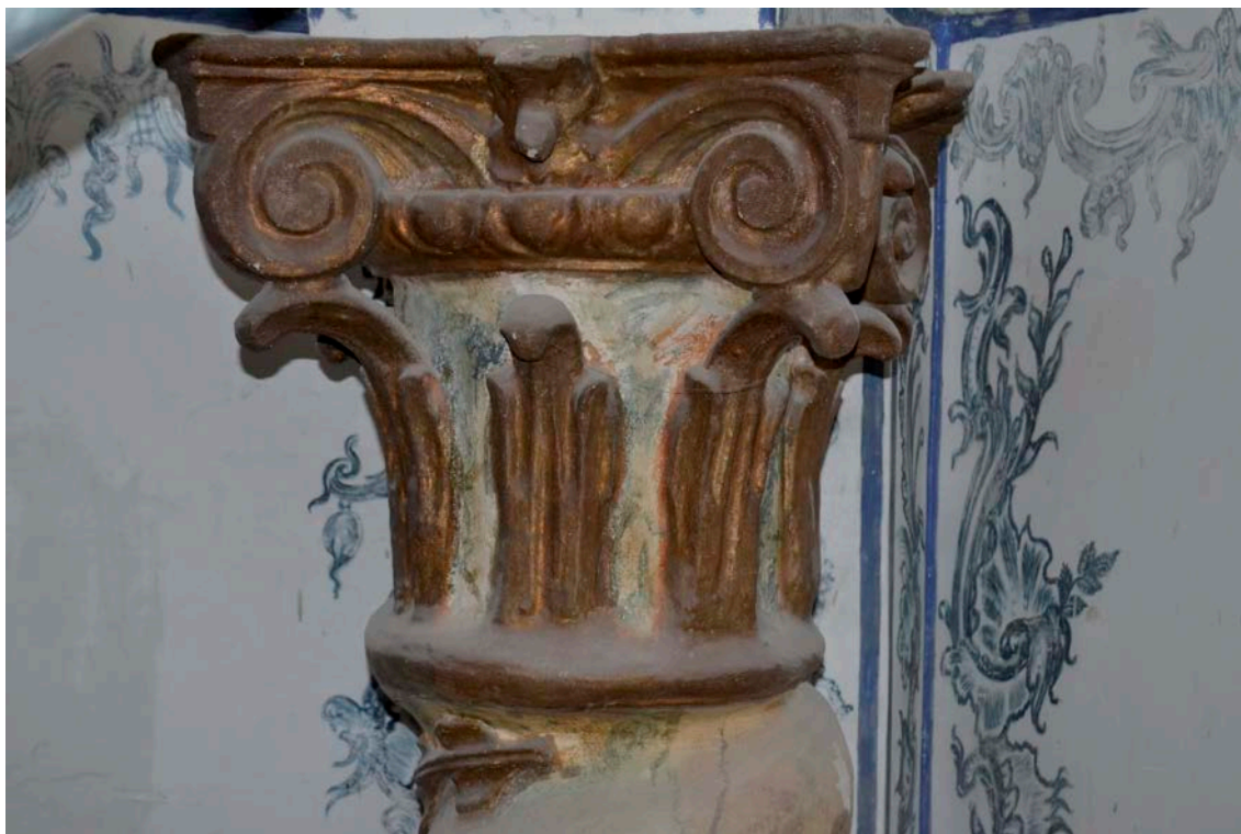
Fig. 6.- Capitel de una de las columnas salomónicas del camarín, dorado con plata corlada por Isidro Carpena, ca. 1781. La corla ha oxidado de forma irreversible. Fotografía: Alberto Martínez, 2022.
